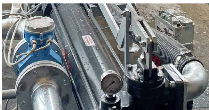
Débitmètre sur pompe
