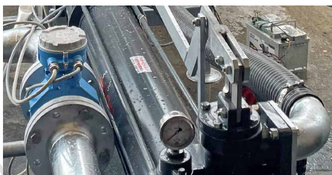
Durchflussmessgerät auf Pumpe
