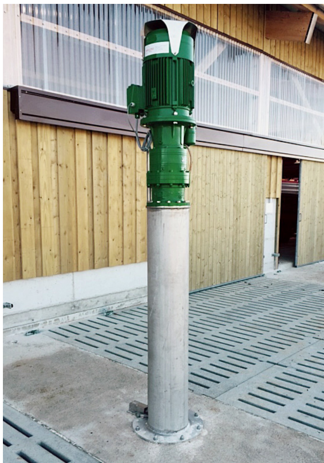
Erhöhte Montage auf Konsole im Laufstall
